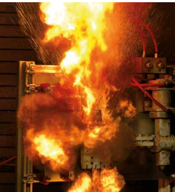
Neuer 250-A-Trennschalter nach aktueller Bauart, geprüft bei 18 kA und 415 V AC. Höhe des Ausgasungsstrahls: 3 m – Icu des geprüften Trennschalters: 36 kA.
