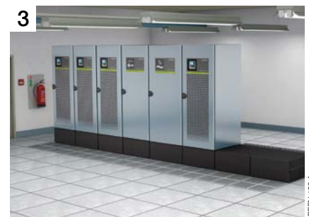
3 30 Minuten später: 800 kW, Online-Doppelwandlermodus
